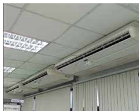
KOOM Airが設置されたオフィスエアコン
