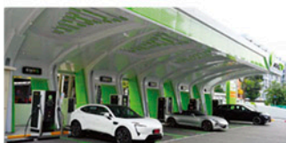
EVサービス拠点「PT GIGA EV」
